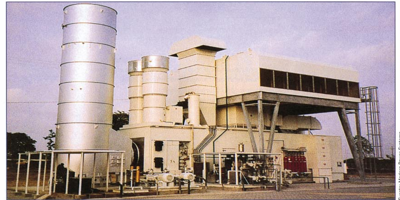
Fuente: Modern Power Systems
